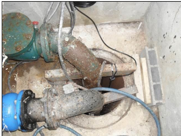
Photographie 2 : Colonne des pompes
