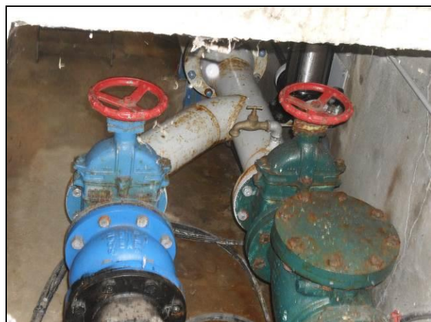
Photographie 3 : Vannes de régulation des débits de pompage et robinet de prélèvement eau brute
